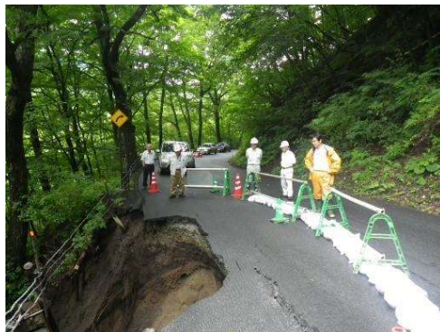
2016年ゲリラ豪雨による路肩の崩落
